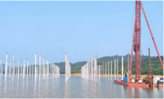
| 大唐华银湘潭石坝口水库光伏项目
