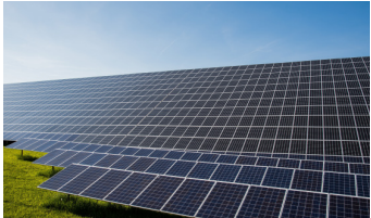
厦门自贸片区港务电力光伏项目
