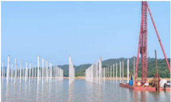
大唐华银湘潭石坝口水库光伏项目
