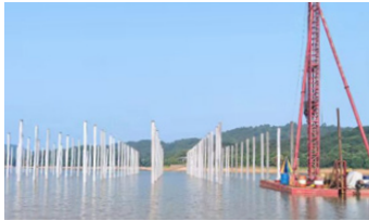
| 大唐华银湘潭石坝口水库光伏项目
